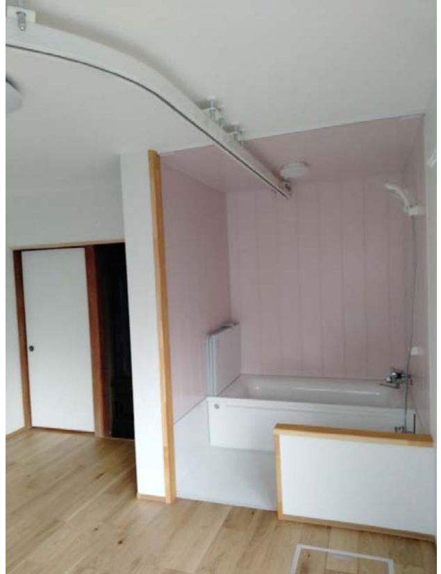
天井走行リフトが設置され
